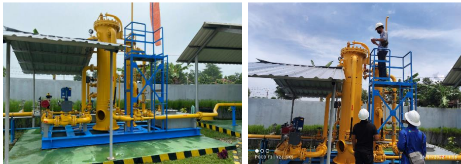
Kegiatan Penyaluran Gas di Stasiun Metering Garawangi antara PT. SMU-PT. CRE
